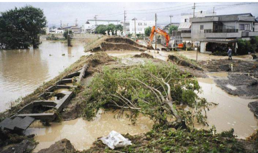
足羽川破堤箇所
